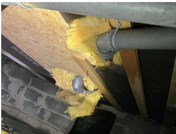
Bild 4: - Utvändigt, Krypgrund, Äldre del Fuktavvisande plastfolie ej utbredd över grundens botten Lokal rötskada noterades i bjä...
