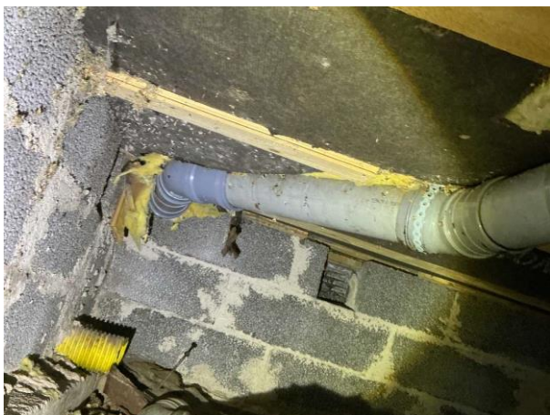
Bild 3: - Utvändigt, Krypgrund, Äldre del Fuktavvisande plastfolie ej utbredd över grundens botten Lokal rötskada noterades i bjä...
