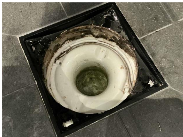
Bild 9: - Invändigt, Entréplan, Renoverat 2023 Kvalitetsdokument saknas Våtrumströskel saknas Brunnsduken är delvis dold av sättbruk
