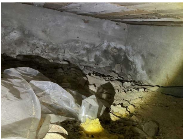
Bild 2: - Utvändigt, Krypgrund, Äldre del Fuktavvisande plastfolie ej utbredd över grundens botten Lokal rötskada noterades i bjä...
