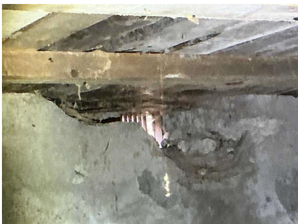
Bild 1: - Utvändigt, Krypgrund, Äldre del Fuktavvisande plastfolie ej utbredd över grundens botten Lokal rötskada noterades i bjä...
