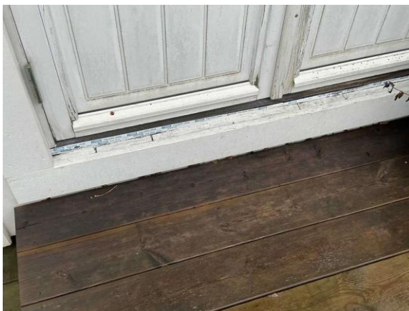
Bild 6: Utvändigt, Ytterdörr, Tröskelbleck saknas på altandörrar
